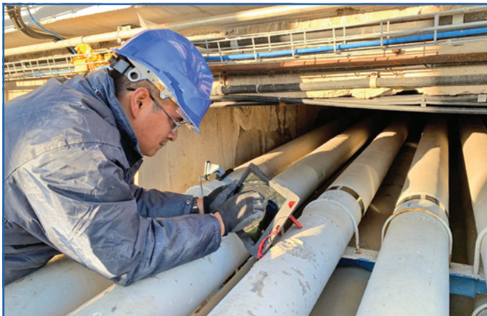
Diagnostika potrubia v tuneli
