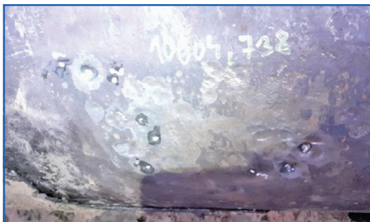
Zhluk korózných chýb v dôsledku jamkovej korózie
